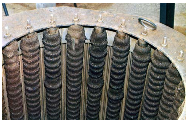
Vista parziale dell'interno di un filtro
